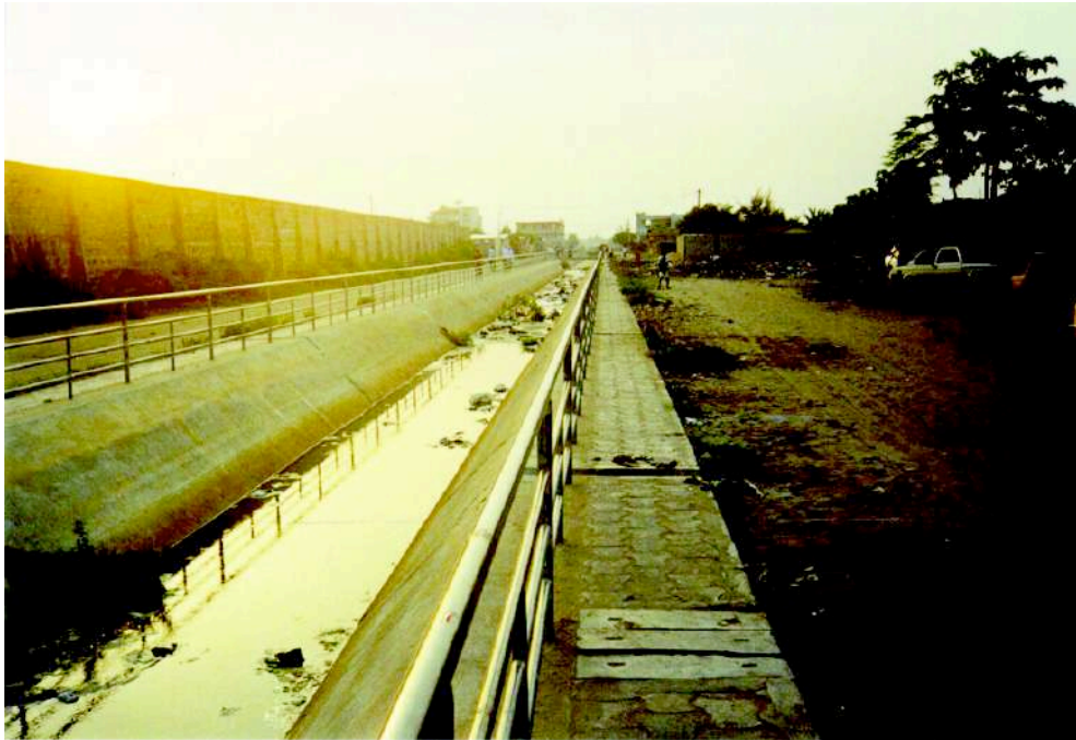
Figura 29 – Canal de drenagem
