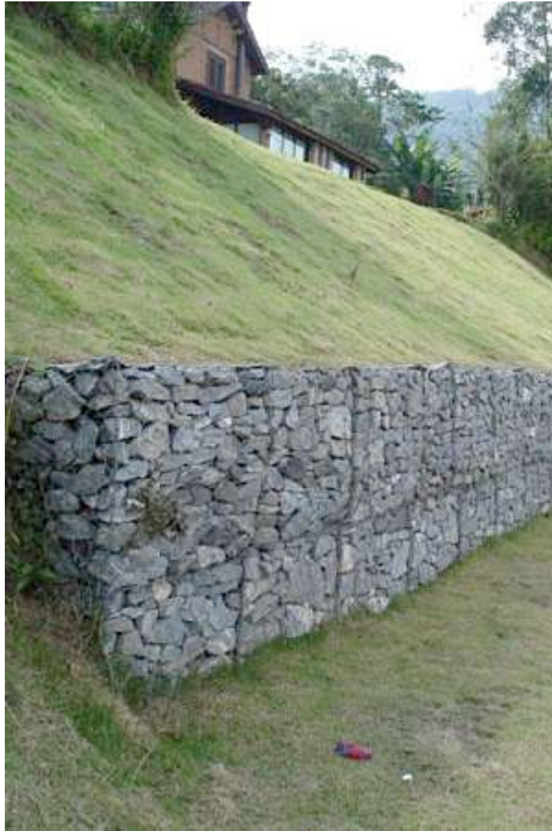
Figura 33 – Muro de arrimo por gravidade feito com gabiões. Petrópolis, RJ. Fonte: dicionario.pro.br Autor: Eurico Zimbres
